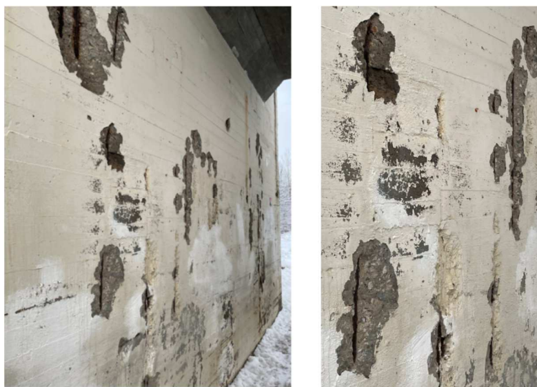
Bilde 1. Oppskraping og blottlegging av armeringsjern på bruvegg. (Foto: Mecamo Consulting AS)
