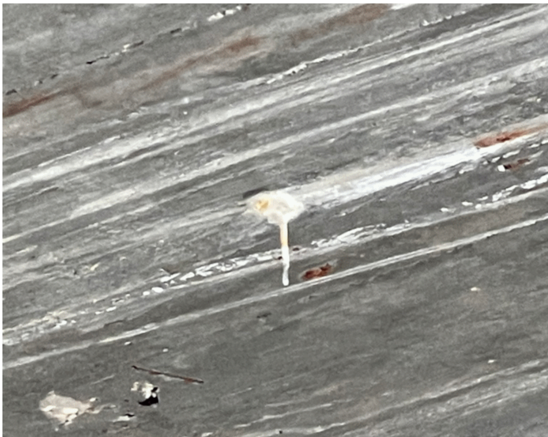
Bilde 6. Alkaliereaksjoner. Stalaktitter på undersiden av en betongstruktur. (Foto: Mecamo Consulting AS)
