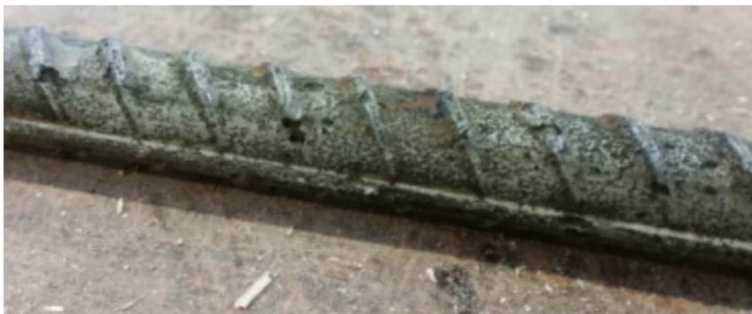
Bilde 8. Kloridindusert korrosjon på armeringsjern. (Foto: /9/)
