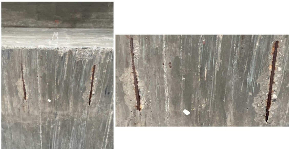
Bilde 2. Oppskraping og blottlegging av armeringsjern. (Foto: Mecamo Consulting AS)
