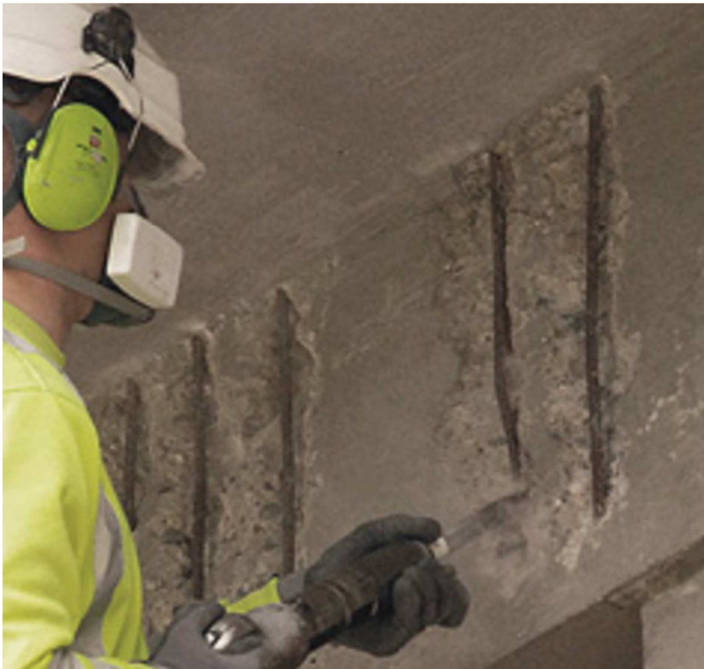
Bilde 17. Bjelke i et parkeringshus. Kloridifisert betong pigges av. (Foto: /3/)
