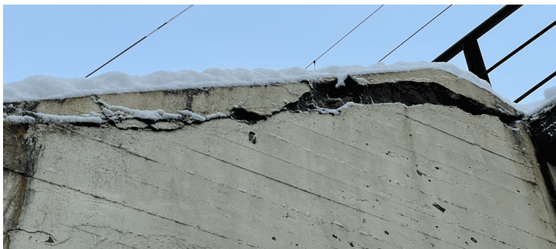
Bilde 3. Oppsprekking som resultat av utmatting av betong i togbru. (Foto: Mecamo Consulting AS)
