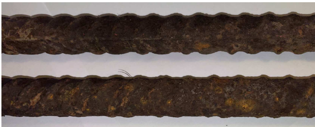
Bilde 7. Generell korrosjon på armeringsjern. (Foto: Mecamo Consulting AS)
