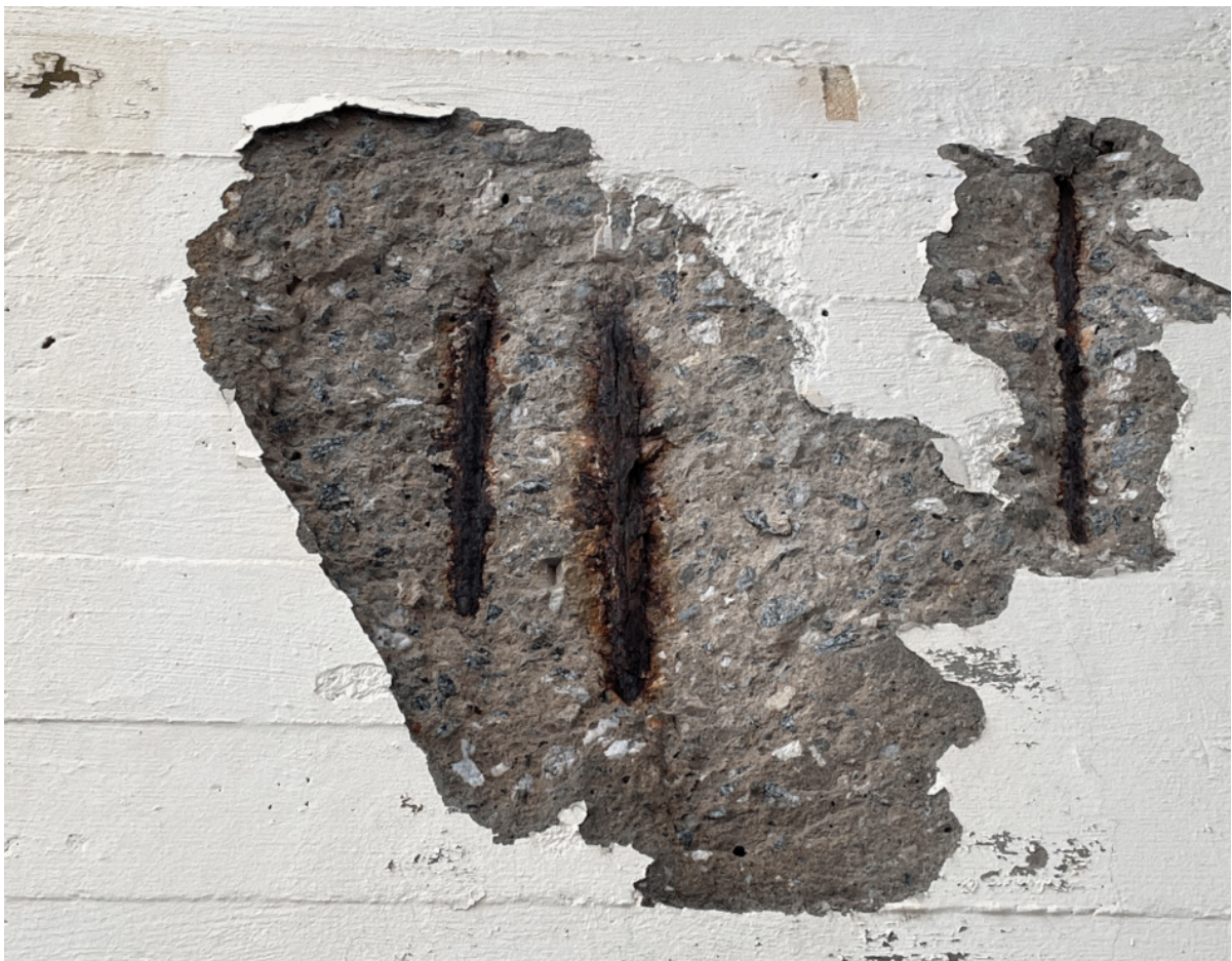
Bilde 16. Armeringsjern fullstendig gjennomrustet. (Foto: Mecamo Consulting AS)
