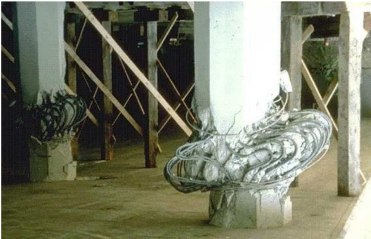
Bilde 9. Delaminering i søyle. Armeringsjernene og betongen i samspill har mistet sin integritet. (Foto: /10/)
