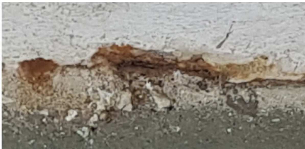
Bilde 11. Misfarging / rustflekker på veggen mot gulvet. Dette skyldes armeringskorrosjon (som er synlig).
