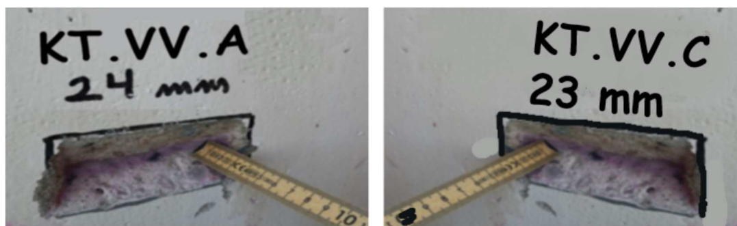
Figur 2. Måling av karbonatiseringsfront ved VV.A. 24 mm og ved VV.B. 23 mm.
